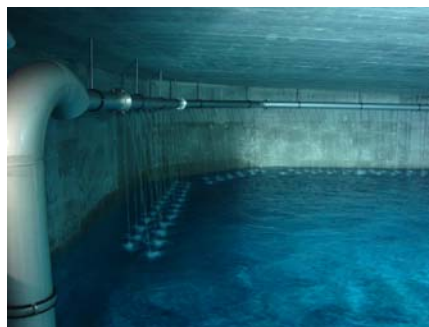
Die Einspeisung des Reservoirs erfolgt über die Quell- und Grundwasserzuläufe
